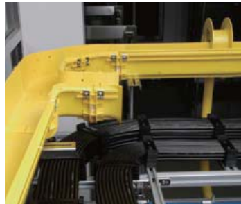
光纖槽道水平三通出口
