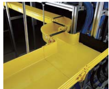
光纖槽道水平彎頭及出口
